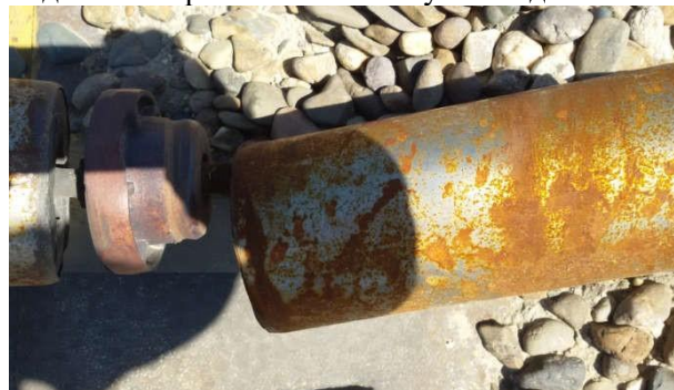
1-расм. Роликларни коррозияланиши кўриниши
